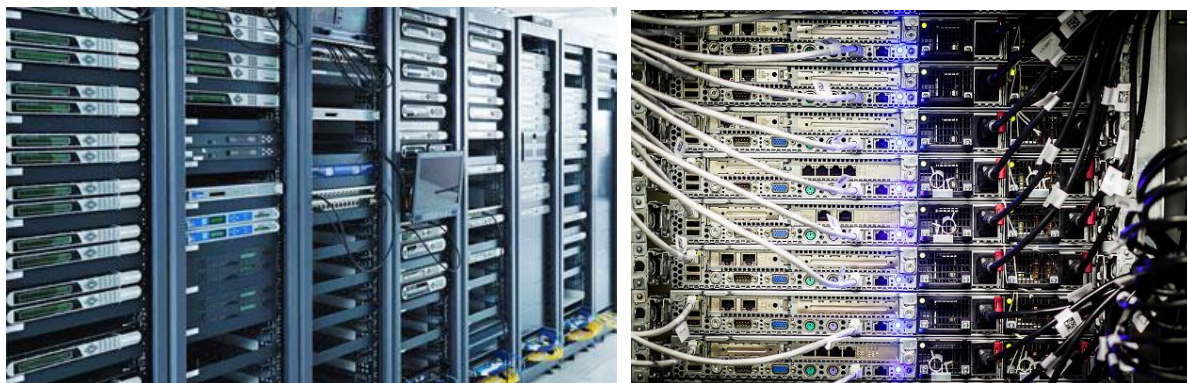
Figura 2.3. Aspecte din interiorul unui centru de date care oferă servicii de cloud computing
